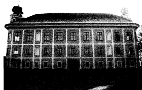
Schloß Gleinstätten, neuerliche Durchfeuchtung über Horizontalisolierung
