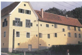
Graz, Schloß St. Peter, Zustand nach „Sanierung“ mit Sanierputz, 1981
