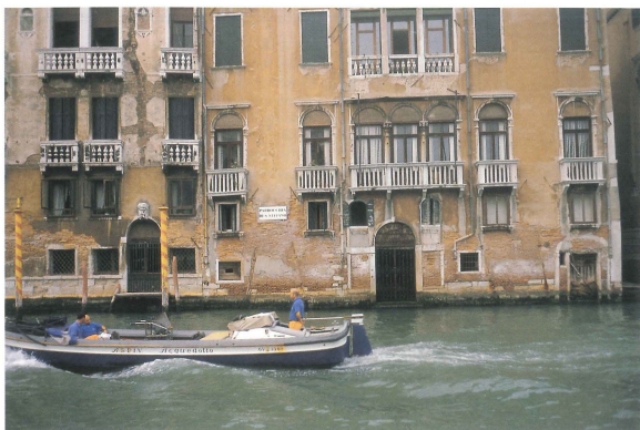
Venedig, Wellen der Motorboote und „acqua alta“ haben die historische Feuchtigkeitssperre überstiegen und zeigen Schäden, primär durch kapillar aufsteigende und sekundär durch hygroskopische Feuchtigkeit
