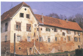
Graz, Schloß St. Peter, ursprüngliches Schadensbild, 1979
