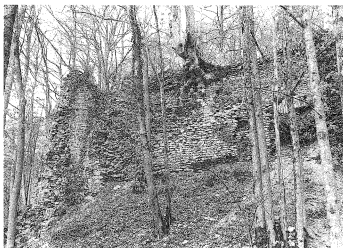
5.6 Montvoie JU. Die einsam gelegene Ruine wird vom Wald hart bedrängt. Der mächtige Wurzelstock in der Bildmitte hat große Teile des Mauergefüges bereits gesprengt.
