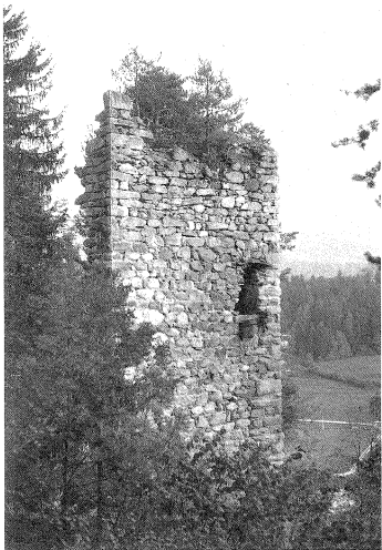
5.5 Grüneck GR. Auflösung des Mauerwerks von oben her infolge Baumwachses auf der Mauerkrone.
