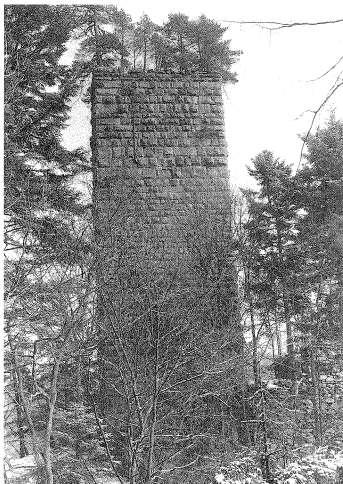
5.3 Wieladingen BRD. Die Bäume auf der Mauerkrone des Turmes gefährden selbst den soliden Buckelquaderverband (Aufnahme vor Beginn der Sanierungsarbeiten).
