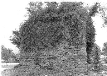
5.8 Seedorf UR. Das Mauerwerk des Turmes verbirgt sich unter dichtem Efeu. Die Bresche in der Mauermitte ist auf künstliche Abbruchtätigkeit zurückzuführen.
