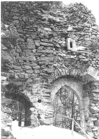
5.4 Wieladingen BRD. Der von oben her durch Wurzelwerk zersetzte Torbau ist kurz nach dieser Aufnahme eingestürzt.
