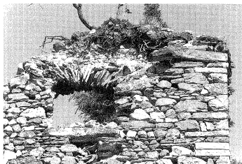
5.15 Splügen GR. Schwere Schäden im Kronenbereich, verursacht durch das Wurzelwerk einer mittlerweile abgestorbenen Föhre. Man beachte, wie der oberste Eckstein durch den Wurzeldruck aus seiner ursprünglichen Lage geschoben worden ist.
