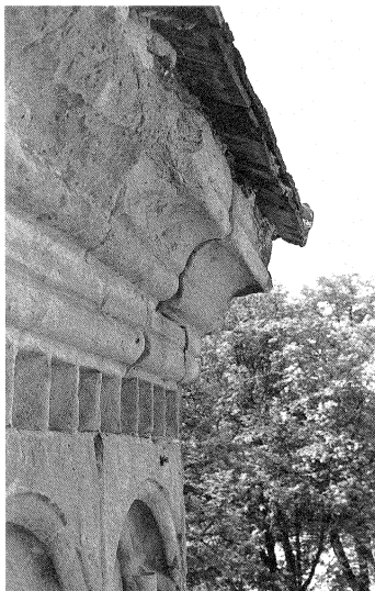
8.3 Mangelhafte Dachwasserentsorgung führt im Regelfall sehr rasch zu tiefenwirkenden Schäden an Dachkonstruktion, Mauerkronen und Gebäudeinnenteilen.
