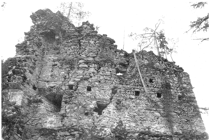
5.1 Obertagstein GR. Schildmauer mit starken, durch Pflanzenwuchs verursachten Auflösungserscheinungen (Zustand vor der Konservierung).
