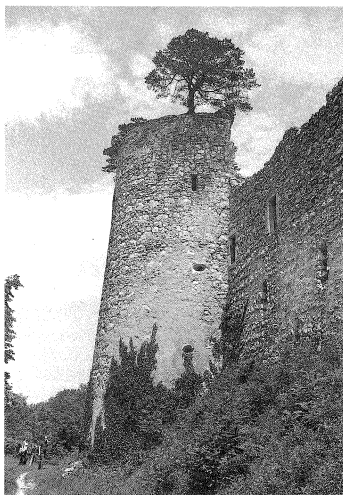
5.2 Dorneck SO. Der mächtige Baum auf der Turmkrone setzt bei Windstößen Mauermassen von mehreren Kubikmetern Inhalt in Bewegung und bewirkt so die allmähliche Zersetzung des Mauergefüges.
